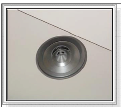
Bouches de Soufflage
