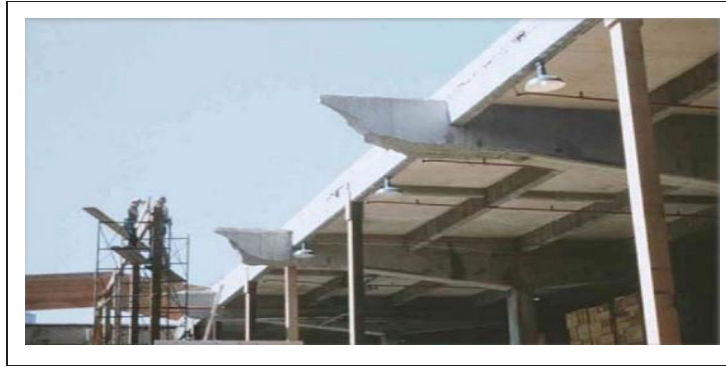
Figure I-2 : Rupture en cisaillement des poutres de l'entrepôt Wilkins à Shelby.
