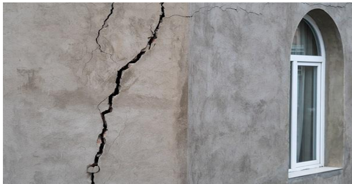
Figure I-1 : Rupture par cisaillement dans une façade de bâtiment [7].
