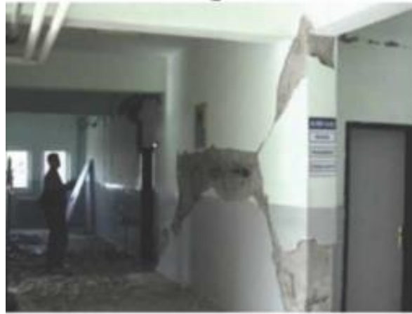
Figure I-3 : Rupture en cisaillement d'un mur (séisme de Turquie, mai 2003).
