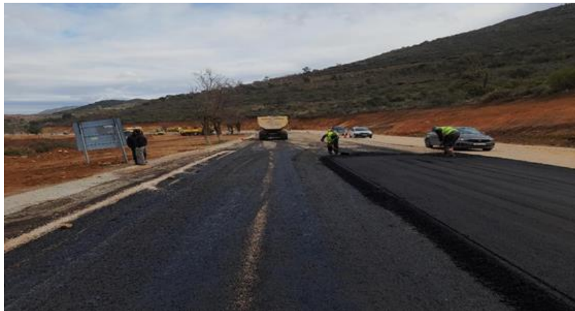
Photo 3.3 Projet en cours de réalisation (Photo prise par la DTP Tlemcen Février 2024)
