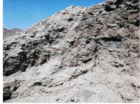
أ. جدار الطوب في احدى غرف القلعة. عن: عريج نجم الدين، حاجي ياسين رايح، جويلية 2022م.
