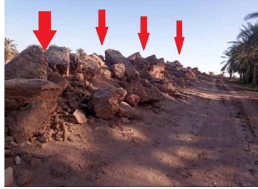
أ. تقنية بناء حصن في منطقة المرموثة، عن عريج نجم الدين، ديسمبر 2021م.
