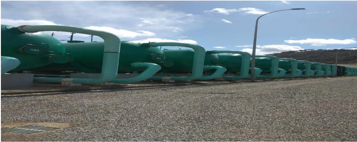
Figure 17 : Les filtres à sable (origine 2024).
