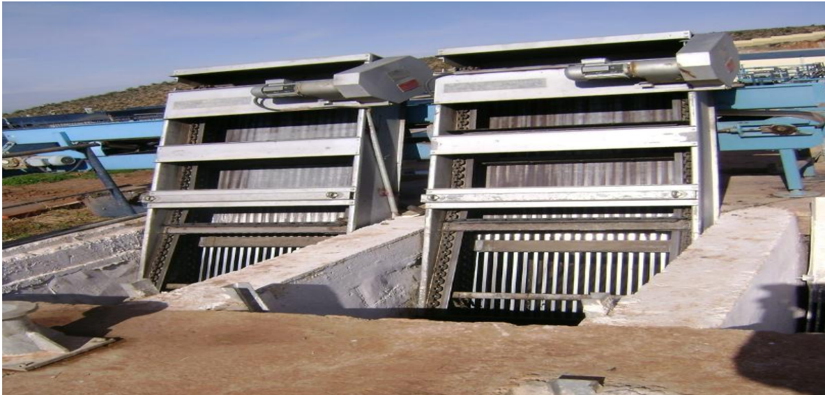
Figure 08 : Grille mécanisée (2 unités)
