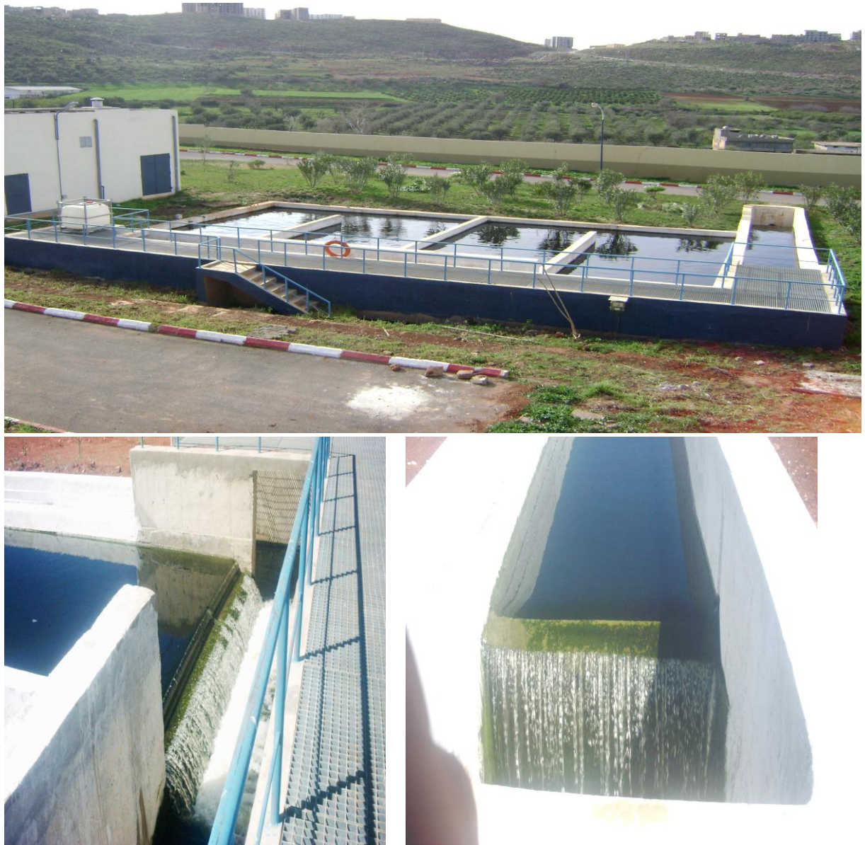
Figure 12 : Bassins de chloration
