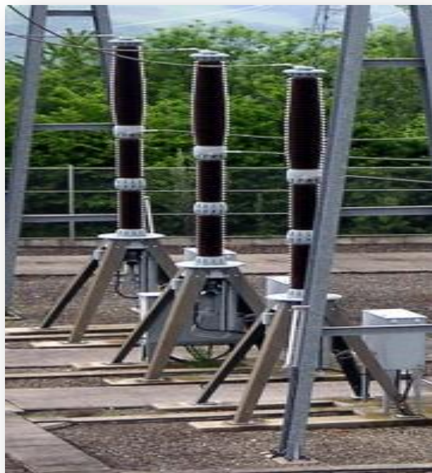
figure II. 2:Disjoncteur à SF 6
