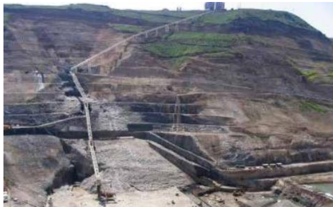
Figure 1.13 : Un système de convoyeur transporte du BCR depuis le sommet d'une montagne jusqu'au site du barrage.
