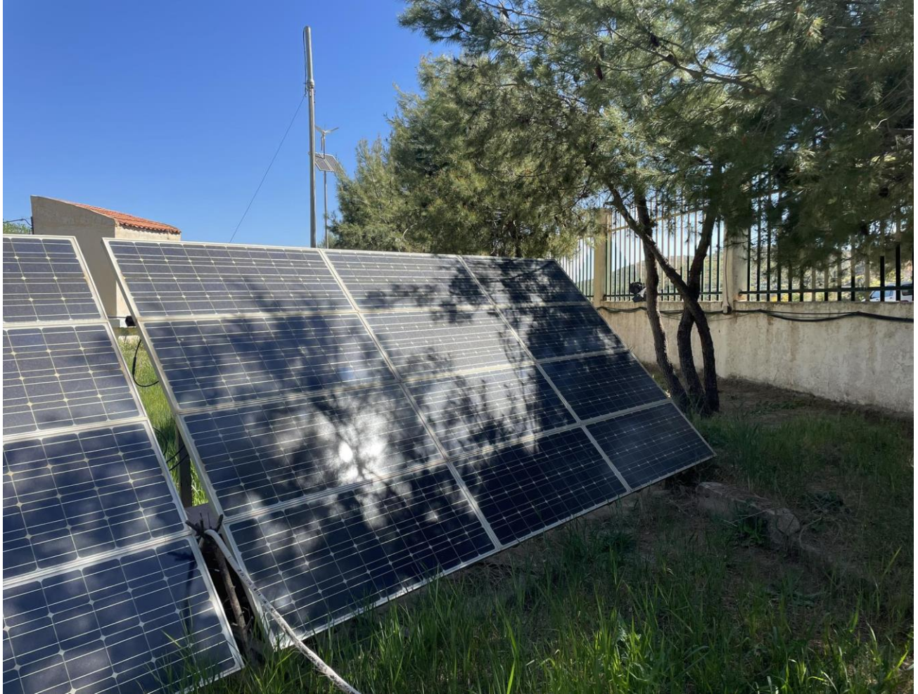
Figure 15 : panneaux solaires partiellement ombré
