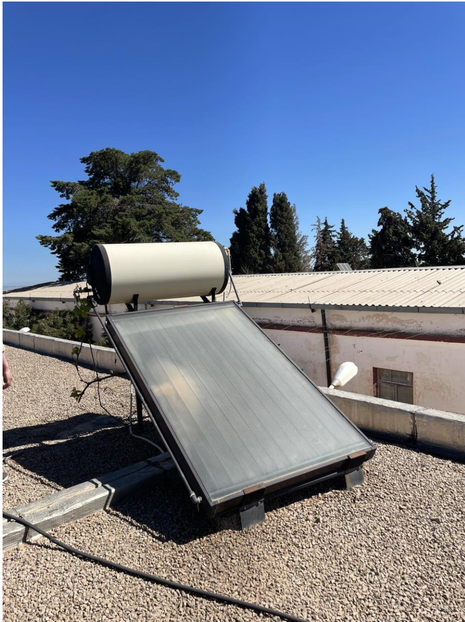
Figure 17 : Une installation de panneaux thermiques
