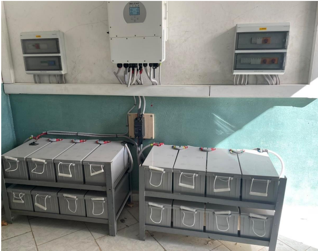
Figure 24 : système de stockage d'énergie Sonelgaz
