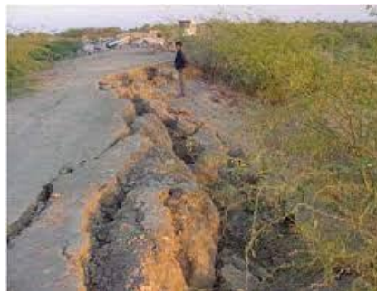
Figure 1.5: déplacements latéraux du terrain
