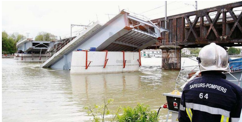
Figure 1.9 : Effondrement des tabliers
