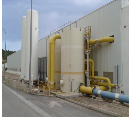
Figure n°09 : Les réservoirs de CO 2 (Station de dessalement-Honâïne)
