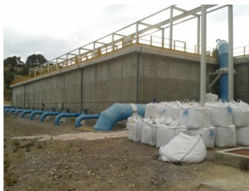
Figure n°08 : Réservoir de l'eau dessalée (Station de dessalement-Honaïne)
