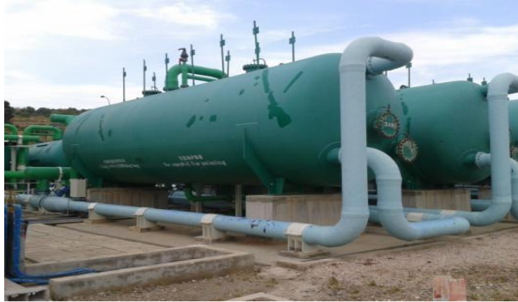
Figure n°03 : filtres à sables et anthracite (Station de dessalement-Honaïne)
