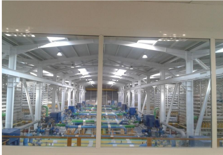
Figure n°06 : L'étape de l'osmose inverse (Station de dessalement-Honaine)
