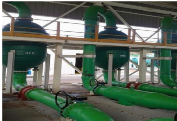
Figure n°04 : filtres à cartouches au niveau de la station (Station de dessalement-Honaïne)
