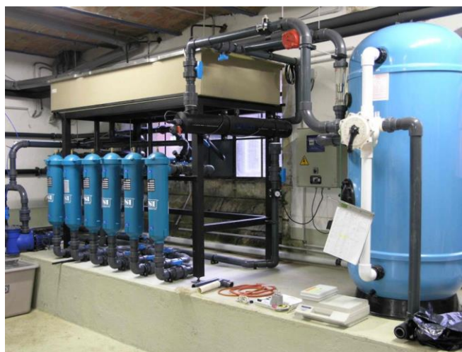
Figure 128; Traitement d'eau d'aquarium
