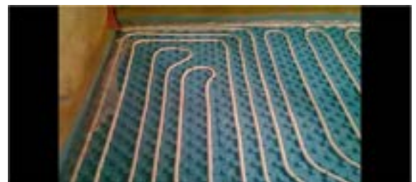
Figure 83: chauffage de hammam Source : Google.image
