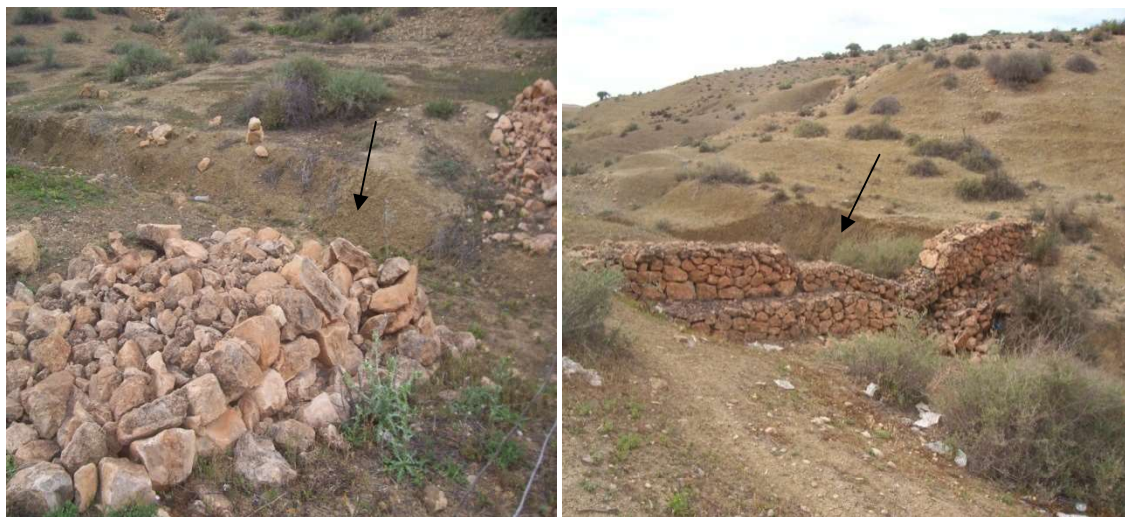
Photo 27 : seuil en pierres sèches déstabilisé à cause d'une mauvaise fondation et déclenchement de l'érosion régressive.
