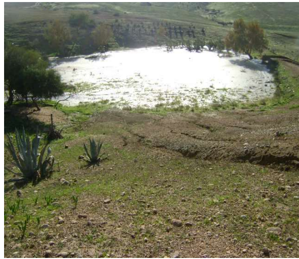
Photo 23 : seuil en terre avec un déversoir cimenté. Vue amont. Cliché Zékri N. Magnia11/12/2012
