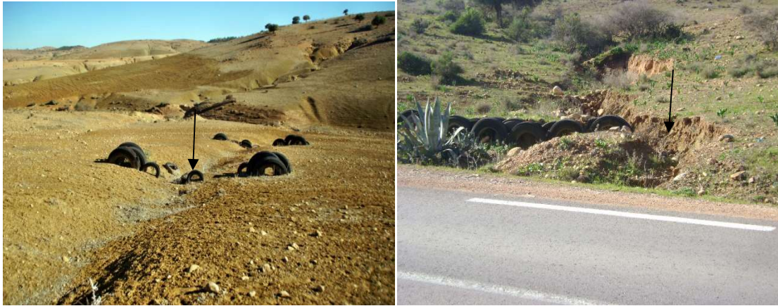
Photo 25 et 26 : seuil en pneus usagers déstabilisé à cause d'une mauvaise fondation (à gauche) et d'un mauvais ancrage et déclenchement du phénomène de renardage (à droite). Cliché Zékri N. Maghnia 11/12/2012
