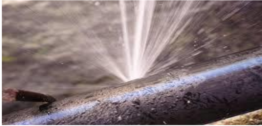
Figure I.10 Détection d'une fuite d'eau enterrée
