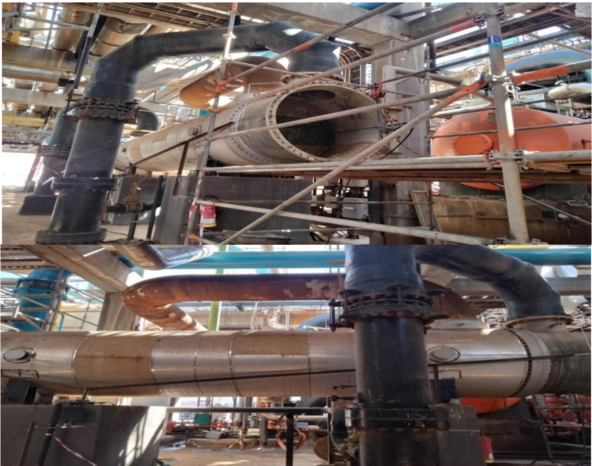
Figure III.2 : Echangeur de chaleur (eau de mer / MCR2).
