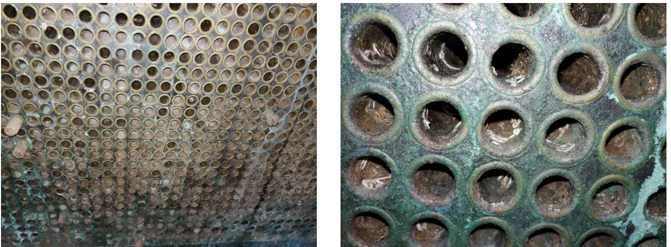
Figure III.10 : Encrassement des tubes réels.
