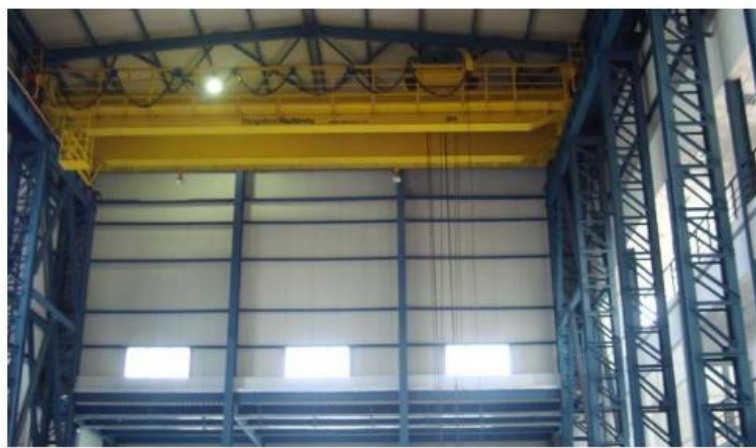
Figure 1.9: Vue sur le pont roulant du laboratoire du CGS [9].
