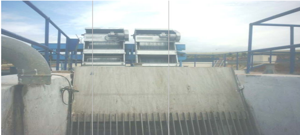
Figure I.7. Grille grossière manuelle (1 unité)
