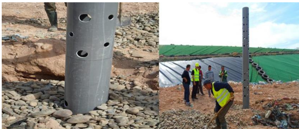
Figure 28: Système récupération de biogaz
