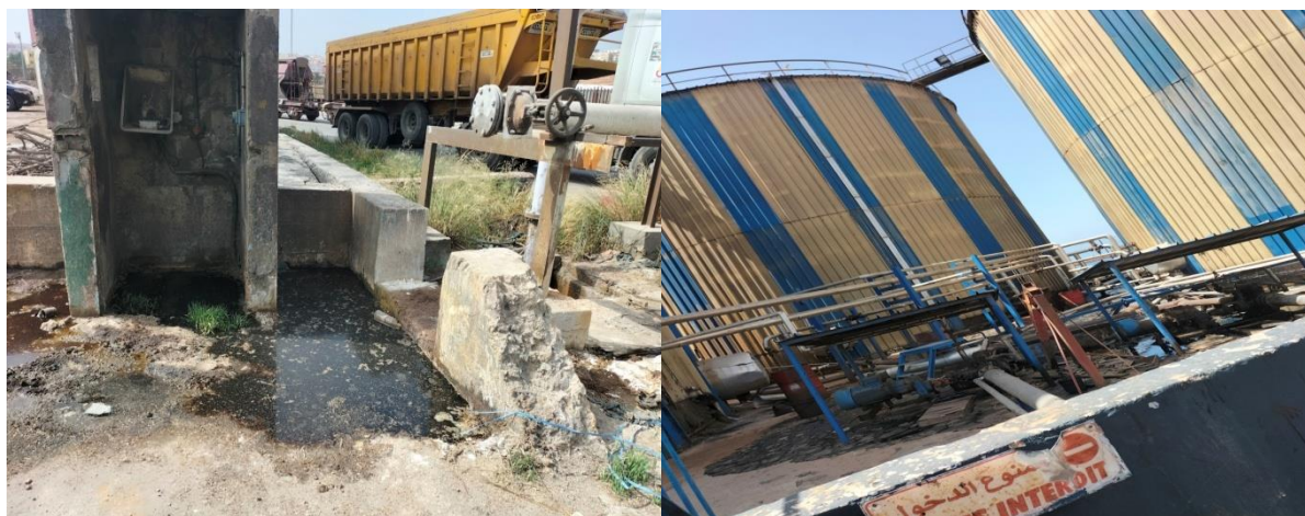
Figure I. 1 : Fuite d'acide sulfurique sur le sol (port Ghazaouet).
