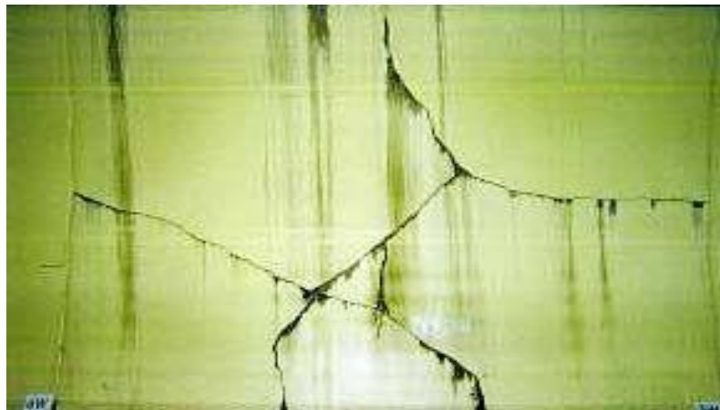
Figure 1.2 Tunnel d'A38 saltash (Royaume-Uni) fissuration sur les parois (Idris, 2007)
