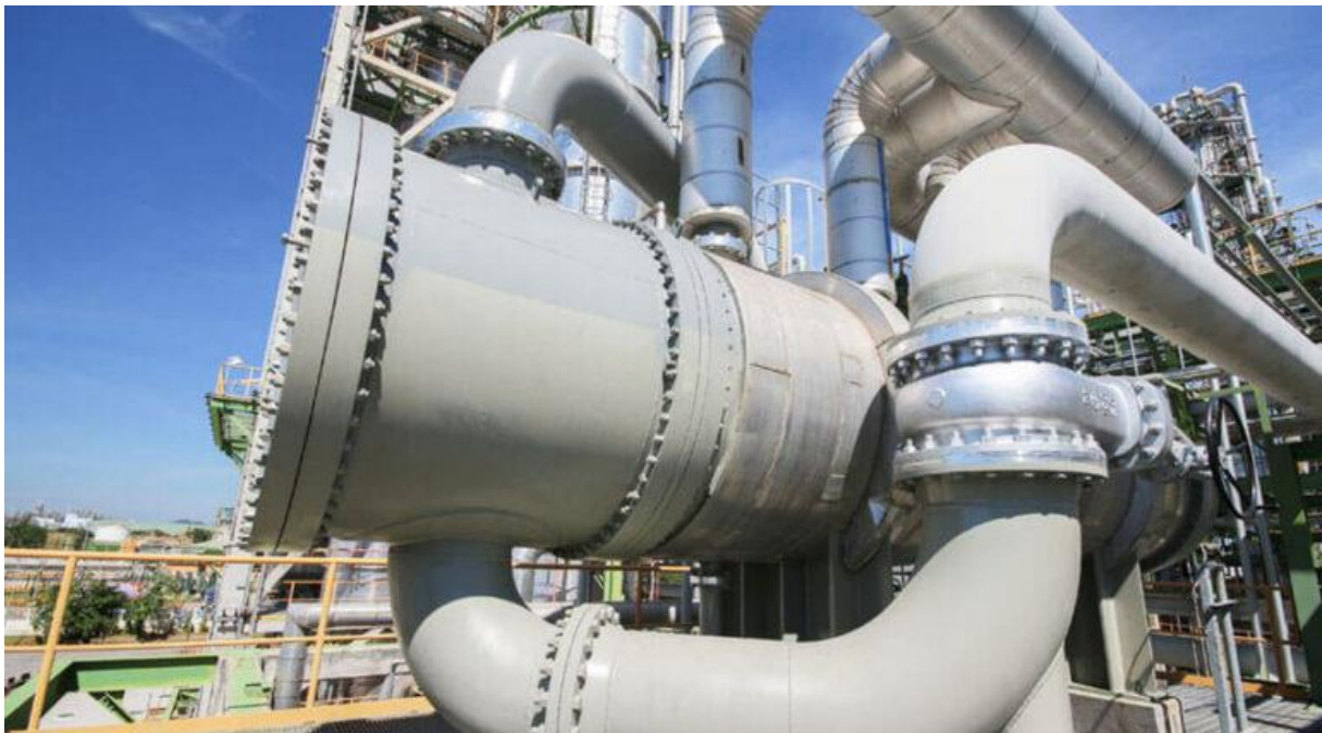
Figure 1.17 : Echangeur de chaleur fonctionne avec haute pression
