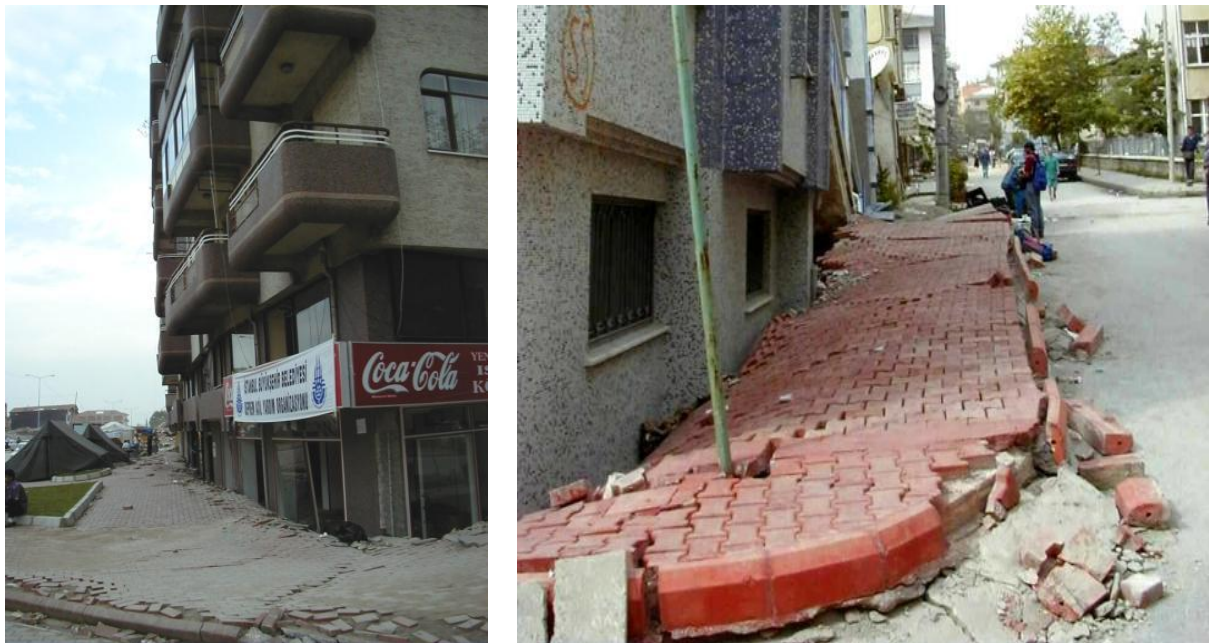
Figure 1. 17: Poinçonnement de la fondation sous la liquéfaction séisme Turquie 1999(D'après Peter M Byrne et al, 2008).
