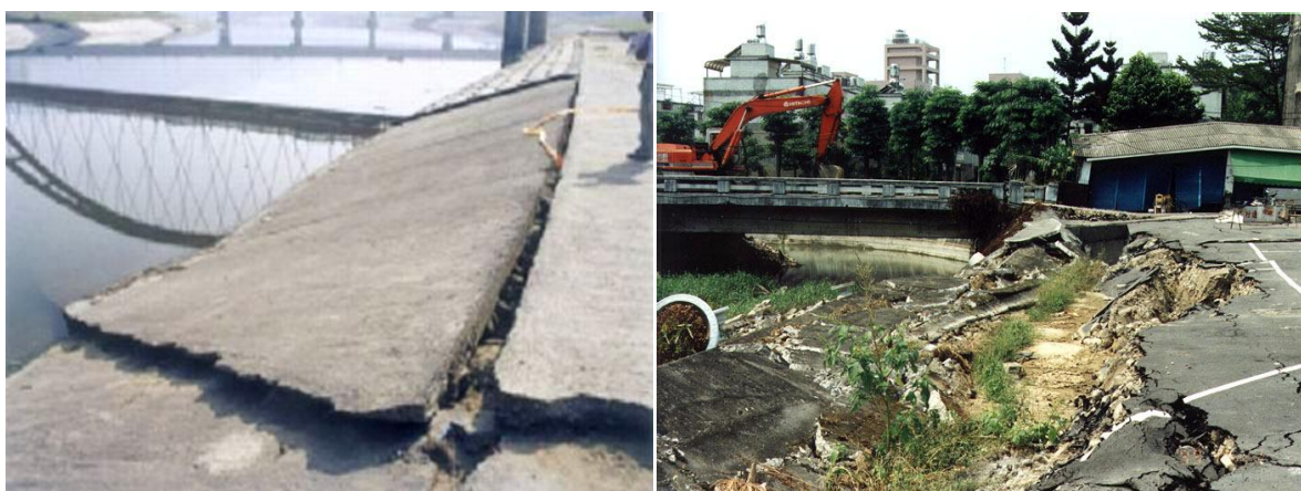
Figure 1. 15: Dommages dûs à l'épandage latéral du sol en place (D'après Dr Hsein, 2002)
