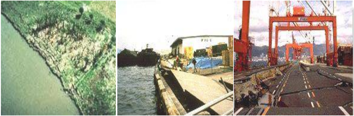
Figure 1. 8: Glissement de murs de quai:(D'aprèsAlisha Kaplan,2004).
