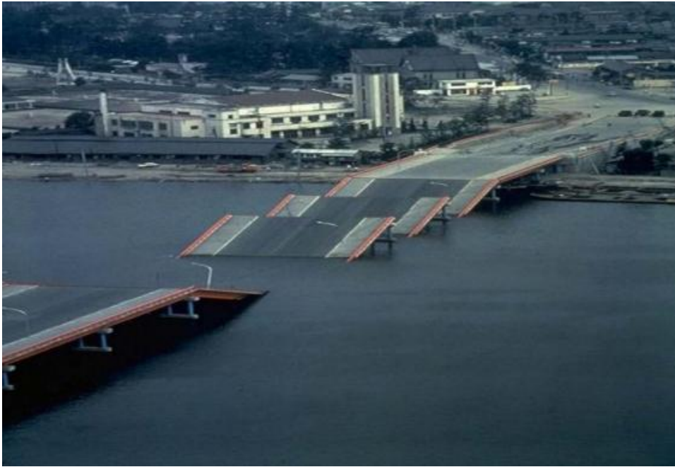
Figure 1. 4: Rupture du pont de Showa , à Niigata au Japon, dues à l'épandage latéral dans le sol (d'après Peter M.Byrne et al,2008).
