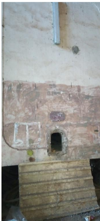
Ouverture de cuve
