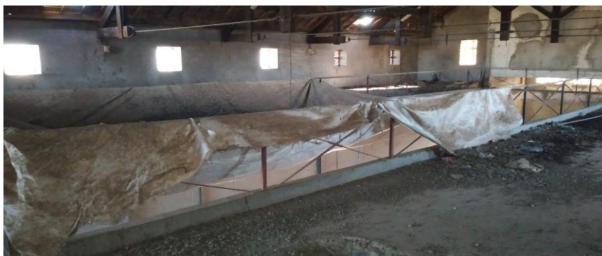
Vue sur le haut des cuves
