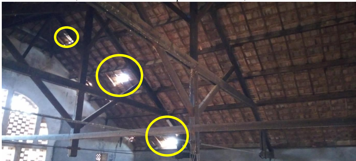
Figure 42: État de la toiture de l'intérieur de la cave 95
