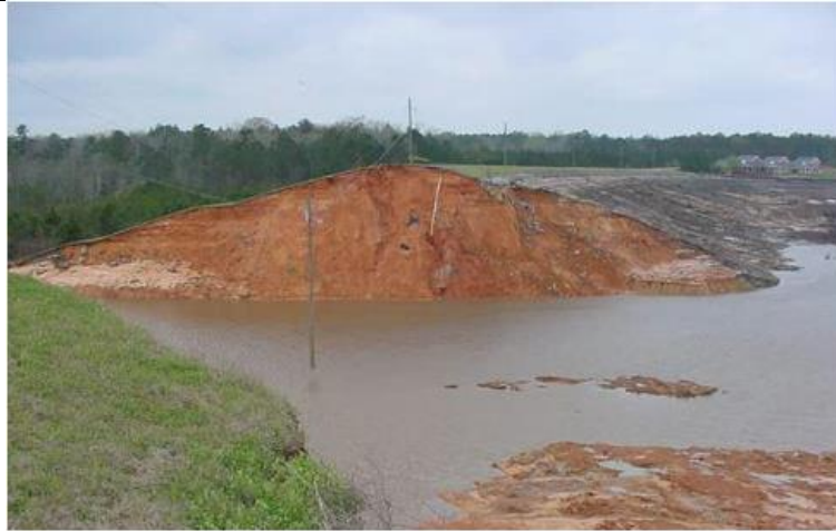
Figure I. 8: Phénomène d'érosion interne barrage de Big Bay [8].
