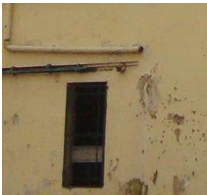
Figure II.5 : Dégradation de l'enduit de la façade.
