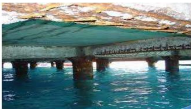
Figure 1: Etat d'un ouvrage dégradé par la corrosion des armatures (Taché,2017)
