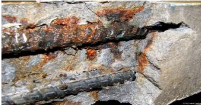
Figure 1.6: L'accumulation des produits de corrosion et l'éclatement de l'enrobage [ https://www.technichem.be/ , consulté le 22 mai 2022]
