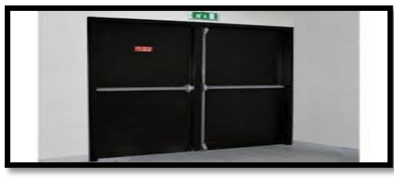
Figure 74 : Portes des issues de secours.
