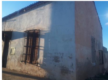
Figure 63: photo de l'état de bâtis Source: Auteur
