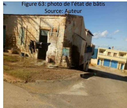
Figure 65: photo de l'état de bâtis Source: Auteur
