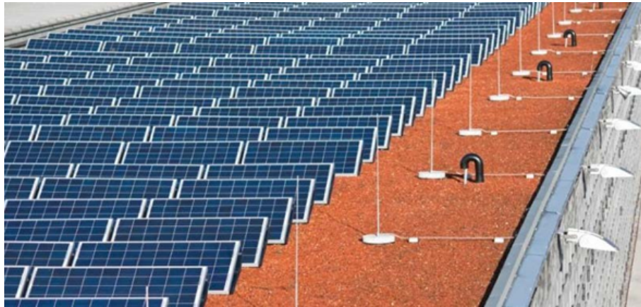
Figure III.3: Système photovoltaïque sur le toit d'un bâtiment
