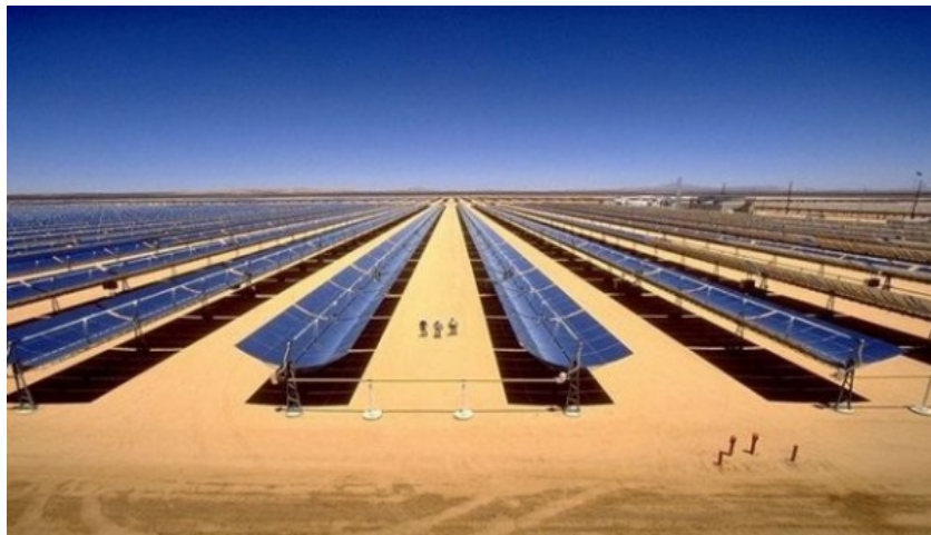
Figure 12: La centrale photovoltaïque de Birr Raba a Ouargla de 10 mégawatts.
