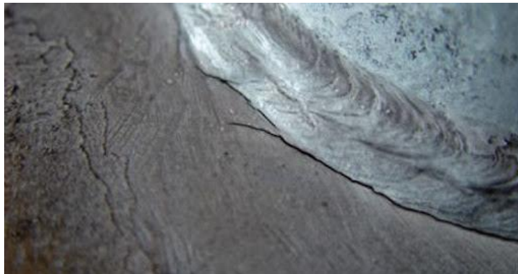
Figure II.10 : fissures aux orteils
