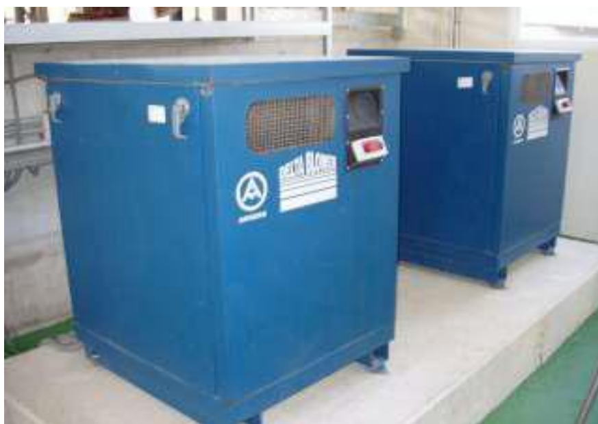
Figure IV.9 : Suppresseur avec cabine d'insonorisation pour l'aération du dessableur-degraisseur
