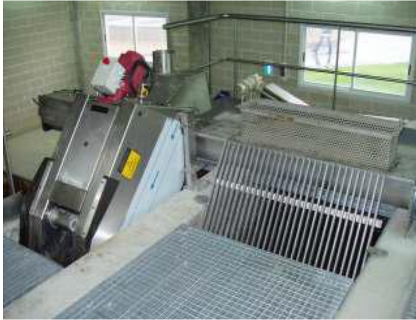
Figure IV.3 : Une grille grossière et manuelle du by-pass
