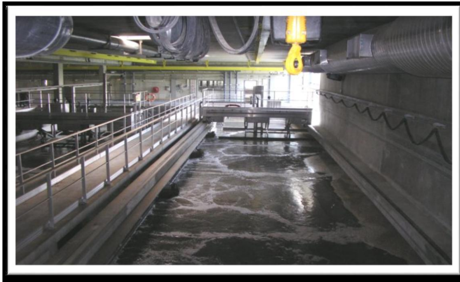
Figure II.5: Bassin de dessablage – dégraissage [2]
