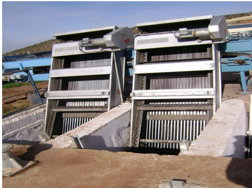
Figure II.3: Dégriateur mécanique de la station AIN Houtz (Tlemcen)
