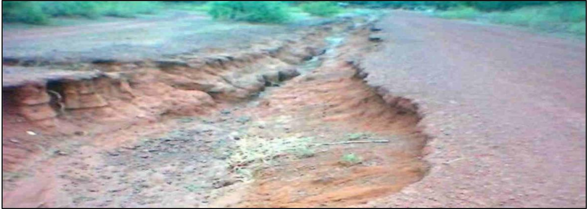
Figure1. 30. Erosion longitudinale. Gravité 3 ( Illustration photographique Planches 8) (Autret, et al., 2009)
