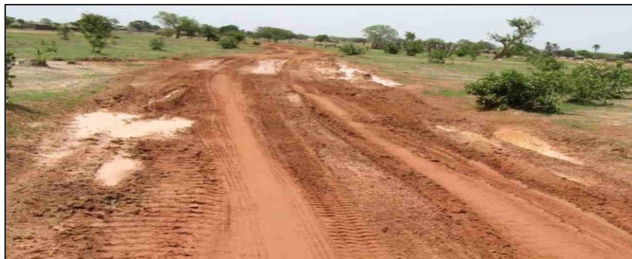
Figure1. 21 . Orniérage et affaissement.
