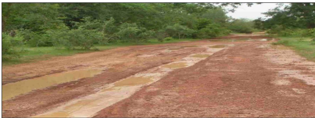
Figure1.23.Orniérage et affaissement se transformant en borbier sous la pluie
