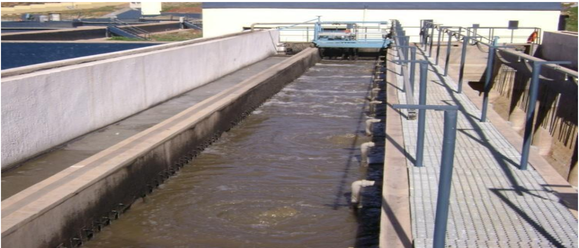
Figure 3.5. : Photo du déssableur- déshuileur. [26]
