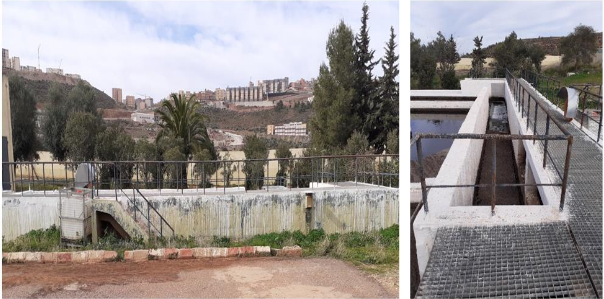
Figure 4.6. : Vue du canal Venturi de la STEP
