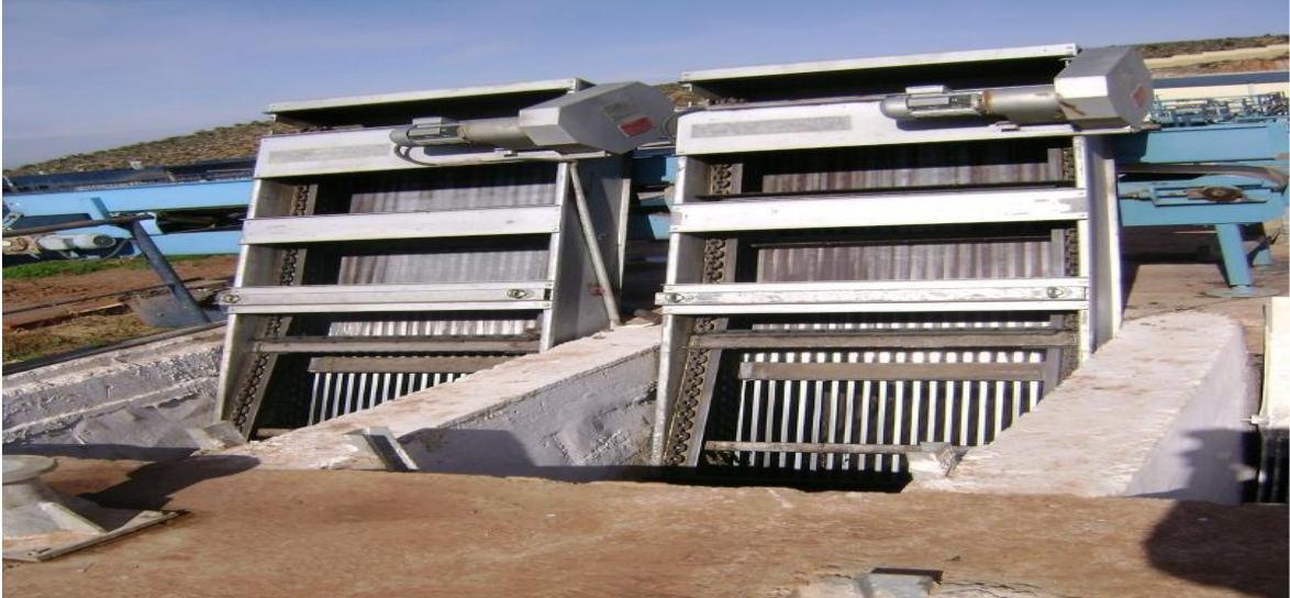
Figure 3.4. : Photo de la grille mécanisée (2 unités)
