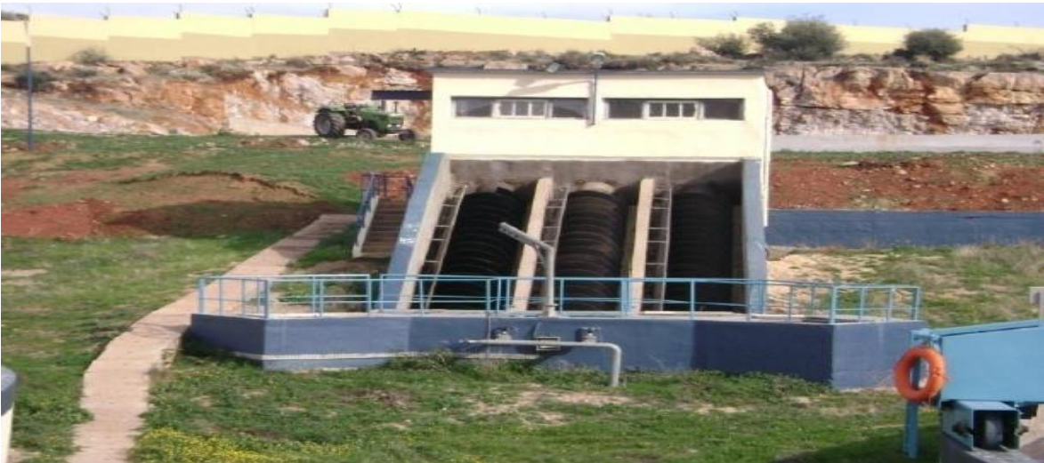
Figure 3.11 : Photo des vis de recirculation des boues.
