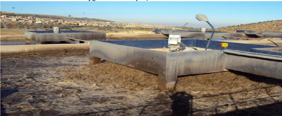
Figure 3.7 : Photo du bassin d'aération
