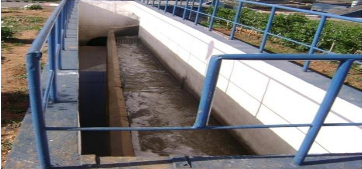
Figure 3.15 : Le déversoir d'orage de la station
