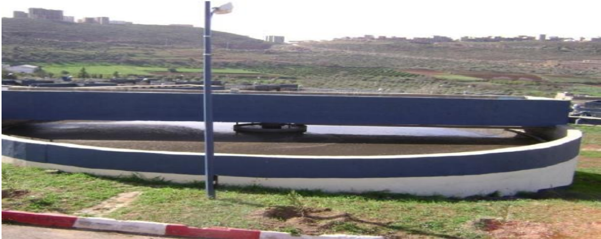
Figure 3.12 : Photo de l'épaississeur des boues. [25]
