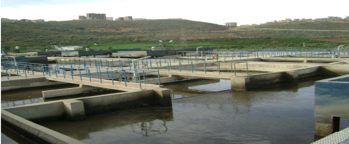
Figure 3.8 : Photo du bassin de nitrification dénitrification
