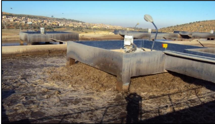
Figure 10 le bassin d'aération.
