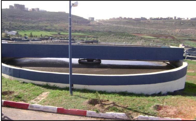
Figure 15 l'épaississeur des boues.
