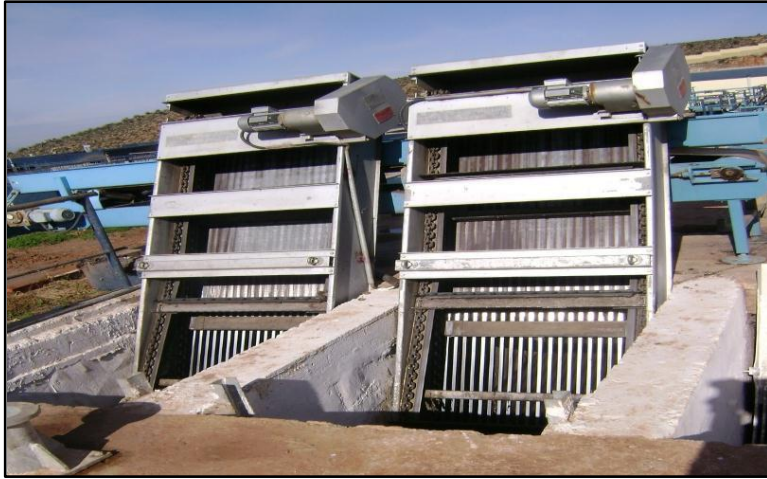
Figure 6 les degrilleurs mécanisés.
