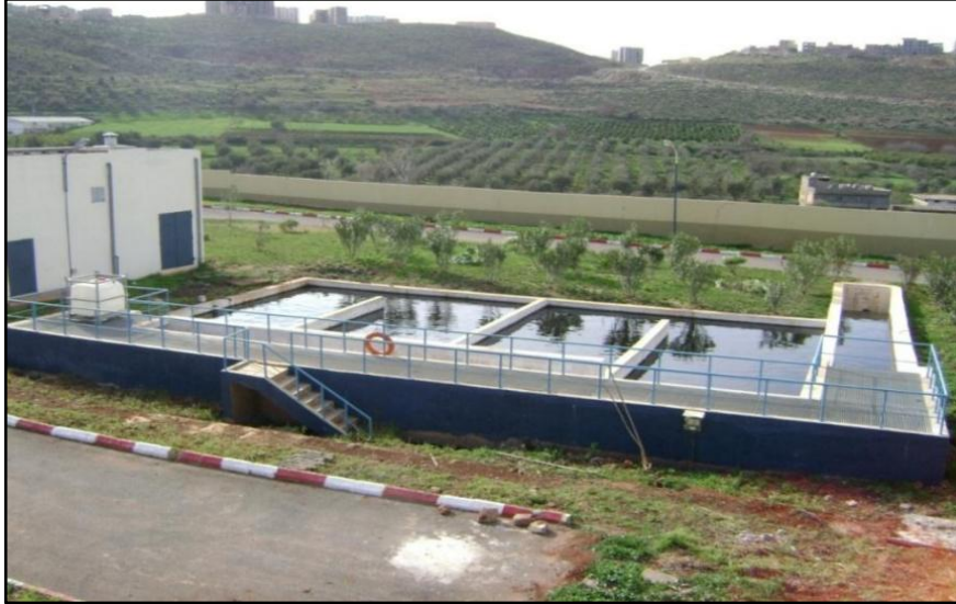
Figure 13 le bassin de chloration.
