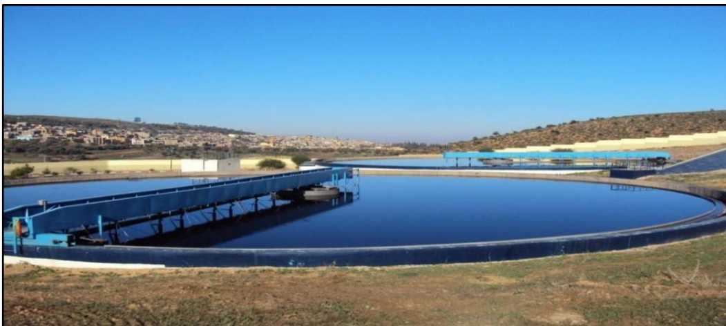
Figure 12 le décanteur secondaire.
