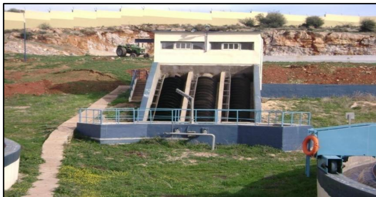
Figure 14 photo des vis de recirculation des boues.
