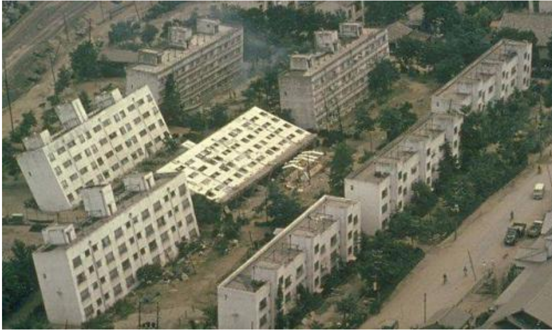
Figure 1.1 Les dégâts causés par la liquéfaction durant le séisme de Niigata 1964(Juang, C. H, 2002)
