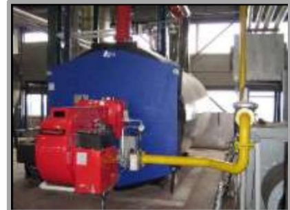
Figure 71 : Chaufferie Eau Chaude
