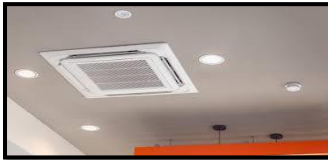
Figure 93 : Cassette de Climatisation et ventilation.
