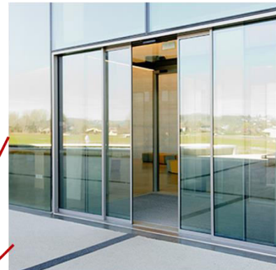
Porte coulissante automatique accès principal
