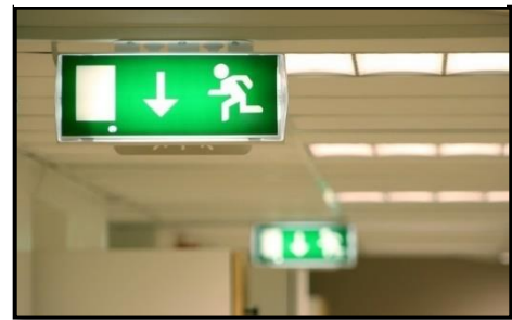
Figure 135. Exemple d'un éclairage de sécurité
