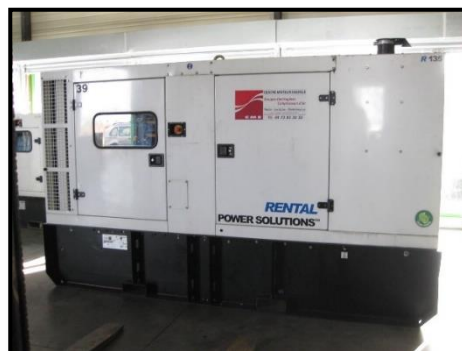
Figure 144. Exemple d'un groupe électrogène
