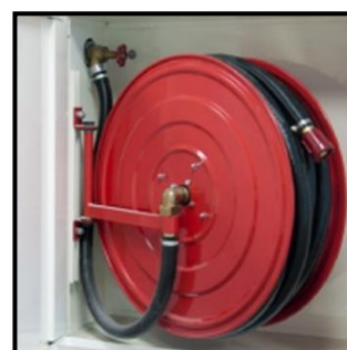
Figure 155. Robinet d'incendie armé
