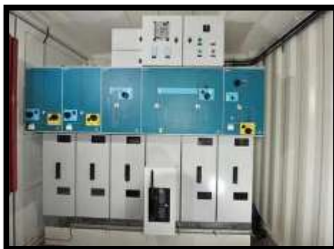
Figure 362 Poste de transformation photovoltaïque
