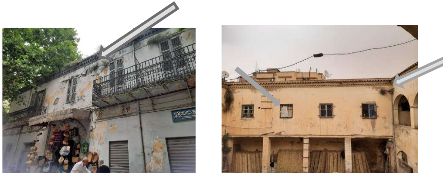
Figure 86: photo de traces d'humidité et la végétation, établi par l'auteur
