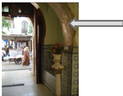
Figure 114: L'incompatibilité des matériaux, l'utilisation d'un enduit en ciment
