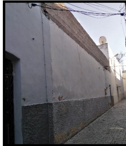
Fig 48 dégradation du cadre bâtis
