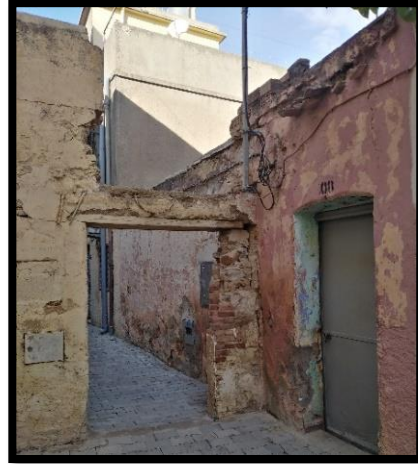
Fig 45 dégradation du cadre bâtis
