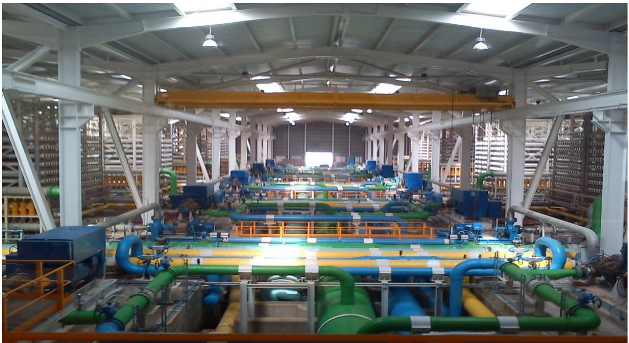
Figure 3.8.12: Photo du bloc d'osmose inverse
