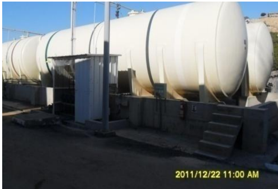
Figure 3.8.7: photo de la citerne de stockage de chlorure ferrique
