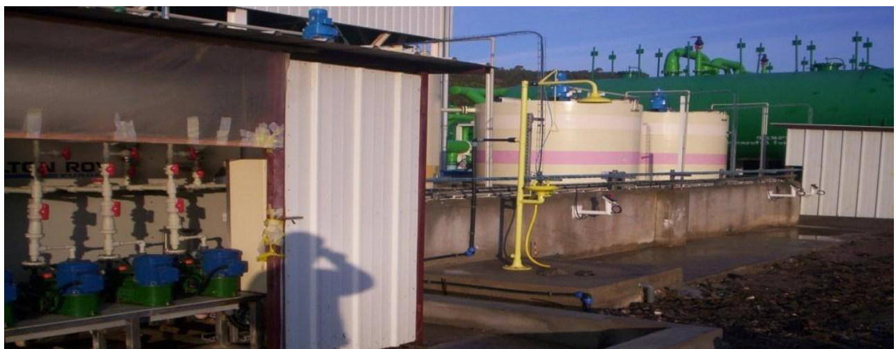
Figure 3.8.8 : Photo des citernes de stockage du métabisulfite de sodium
