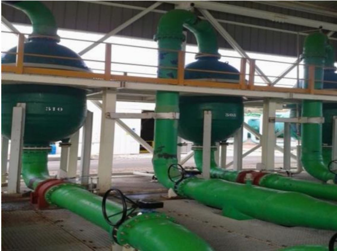
Figure 3.8.11 : filtres à cartouches au niveau de la station (Station de dessalement-Honaïne)
