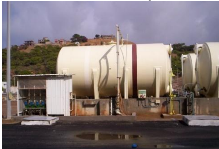
Figure 3.8.6: Photo d'une citerne de stockage d'hypochlorite de Sodium
