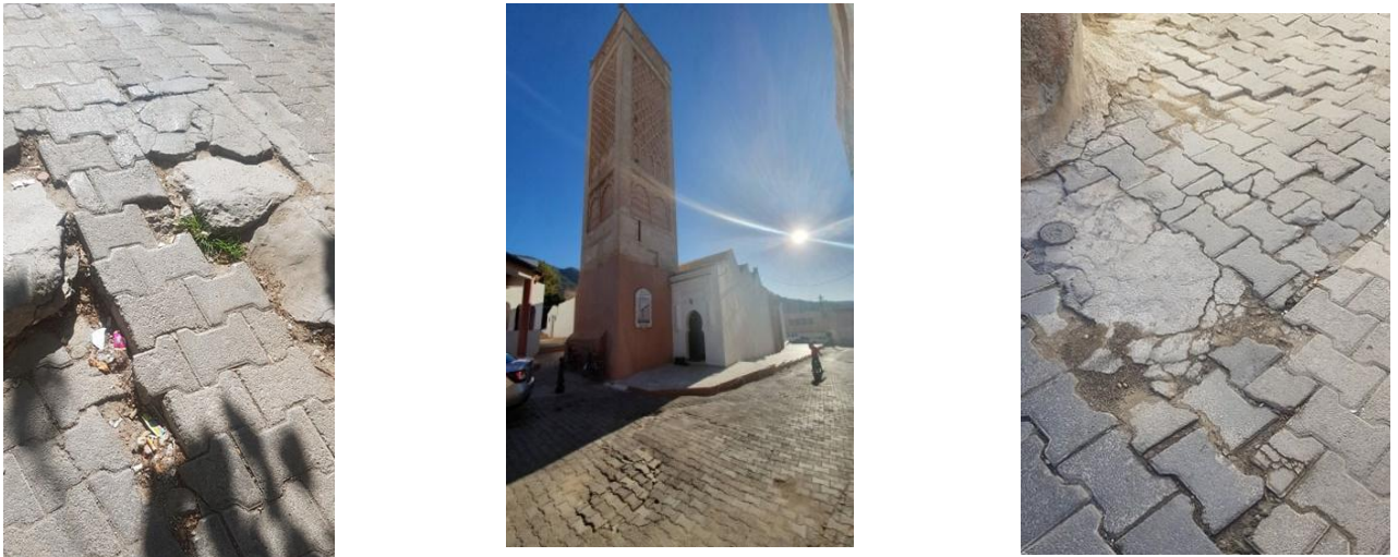
Figure 32: état des voies du centre de la vieille ville Source : auteur
