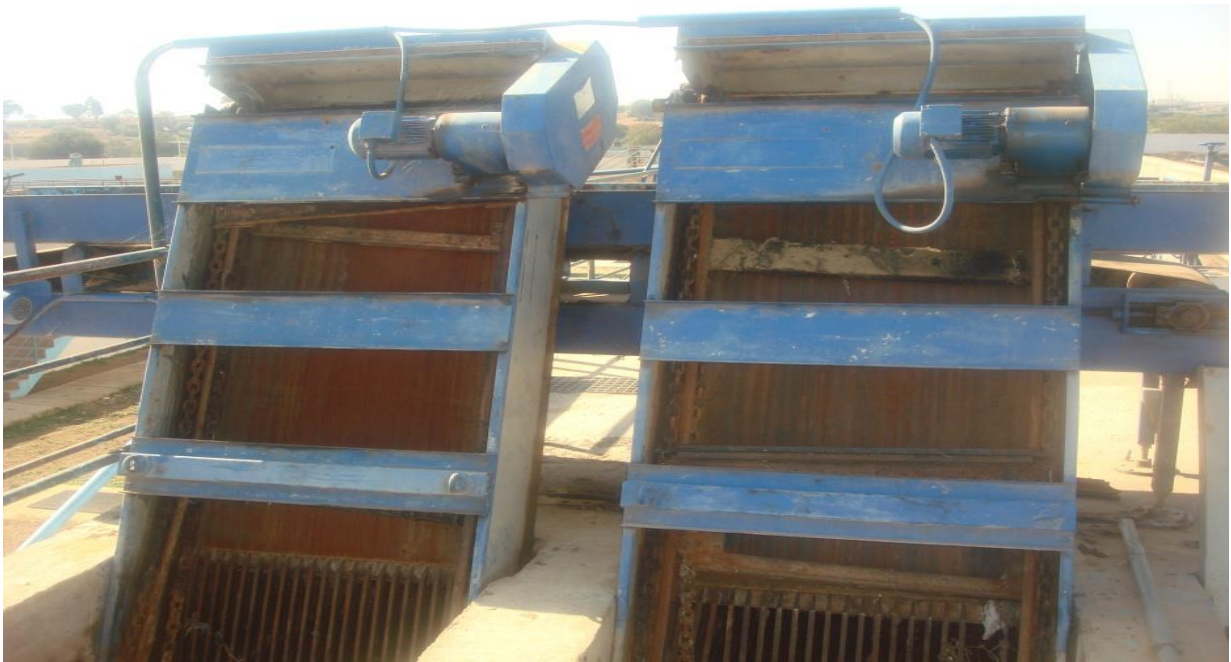
Figure 44 : Grille manuelle De By-pass (1unité). (La D.R.E de la wilaya de Tlemcen et la Zone d'Oran (ONA 2003).
