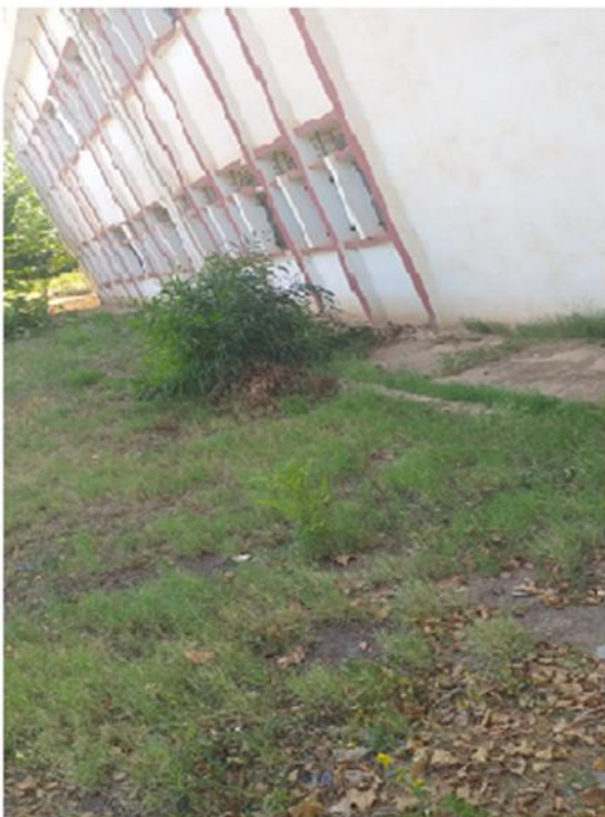
Figure 3.11 : Présence de végétation sauvage autour du bloc B
