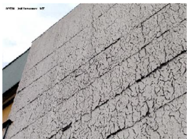
Figure 1.14 : Fissuration d'enduit en façade
