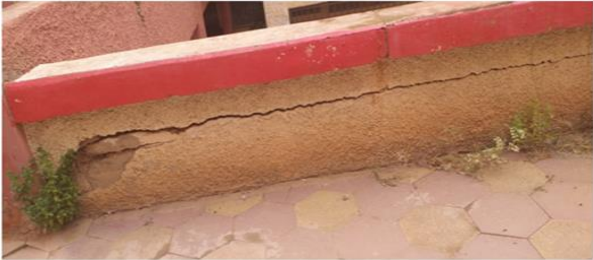
Figure 3.28 : Fissure lézarde au niveau du mur à côté du bloc des laboratoires
