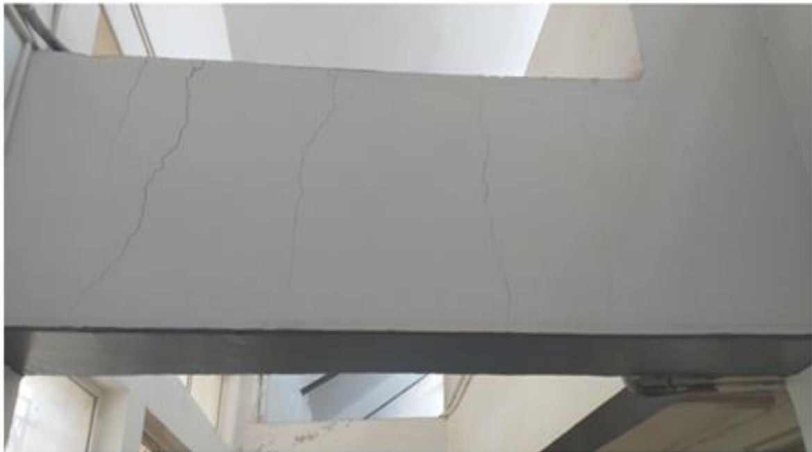
Figure 3.27 : Fissure verticale au niveau de la poutre du hall du bloc des laboratoires
