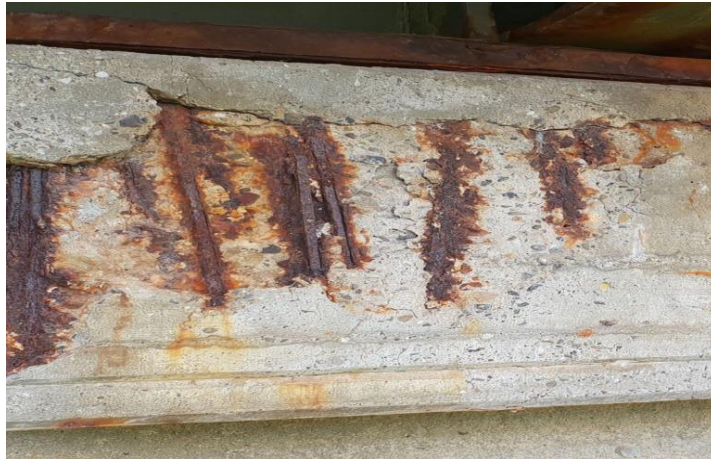
Figure 1.12 : Corrosion des armatures
