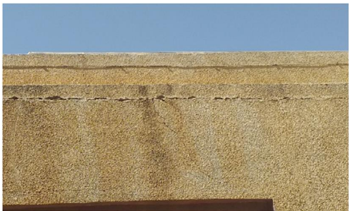
Figure 3.9 : Fissure traversant le mur extérieur du bloc des grands amphis
