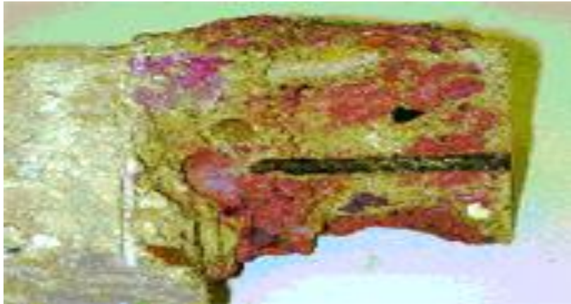
Figure 1.18 : Carbonatation du béton
