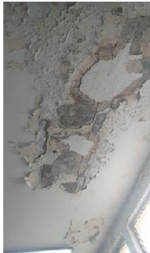
Figure 3.24 : Traces d'humidité très importantes au niveau du planché du laboratoire de traitement des eaux
