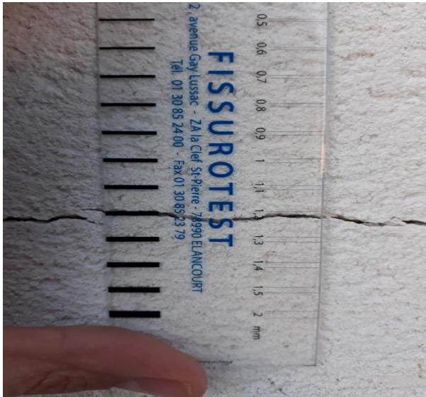
Figure 1.7 : Mesure de la largeur d'une fissure
