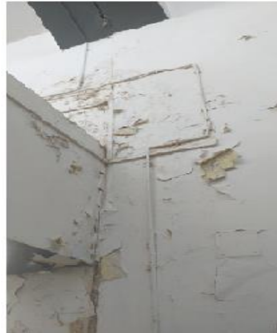
Figure 3.30 : Traces d'humidité importantes au niveau de la poutre et au mur du laboratoire de matériaux de construction
