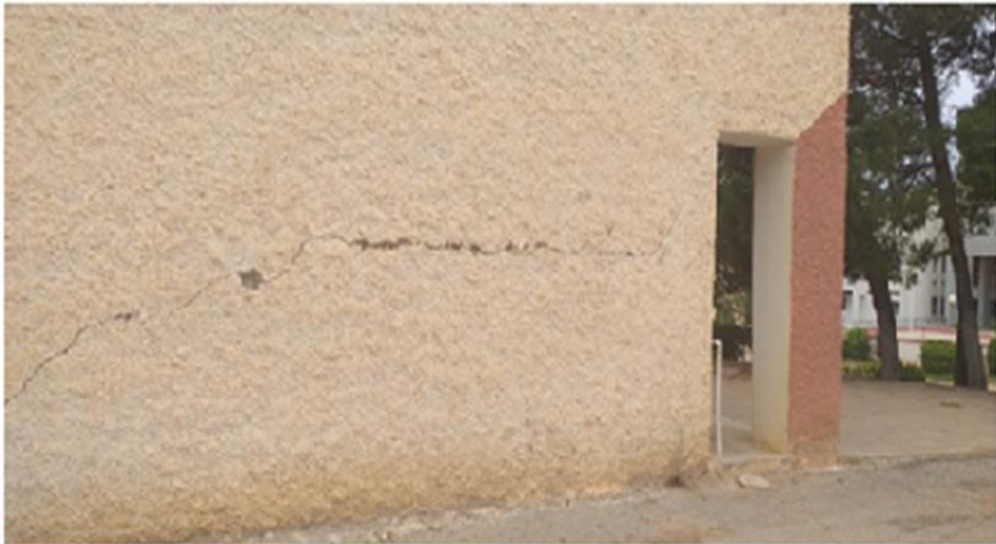
Figure 3.22 : Fissure transversale au niveau du mur extérieur du bloc des laboratoires
