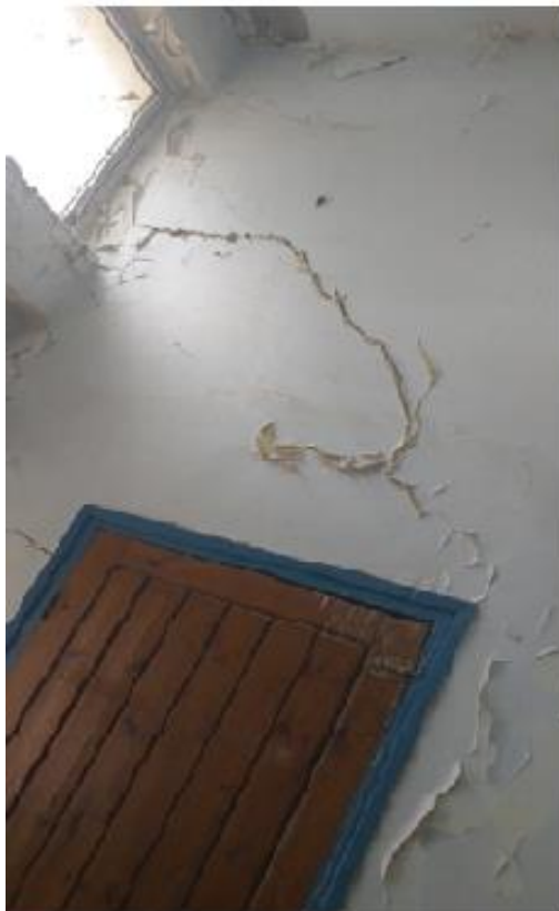
Figure 3.23 : Fissure en moustache au niveau de la maçonnerie du laboratoire de traitement des eaux
