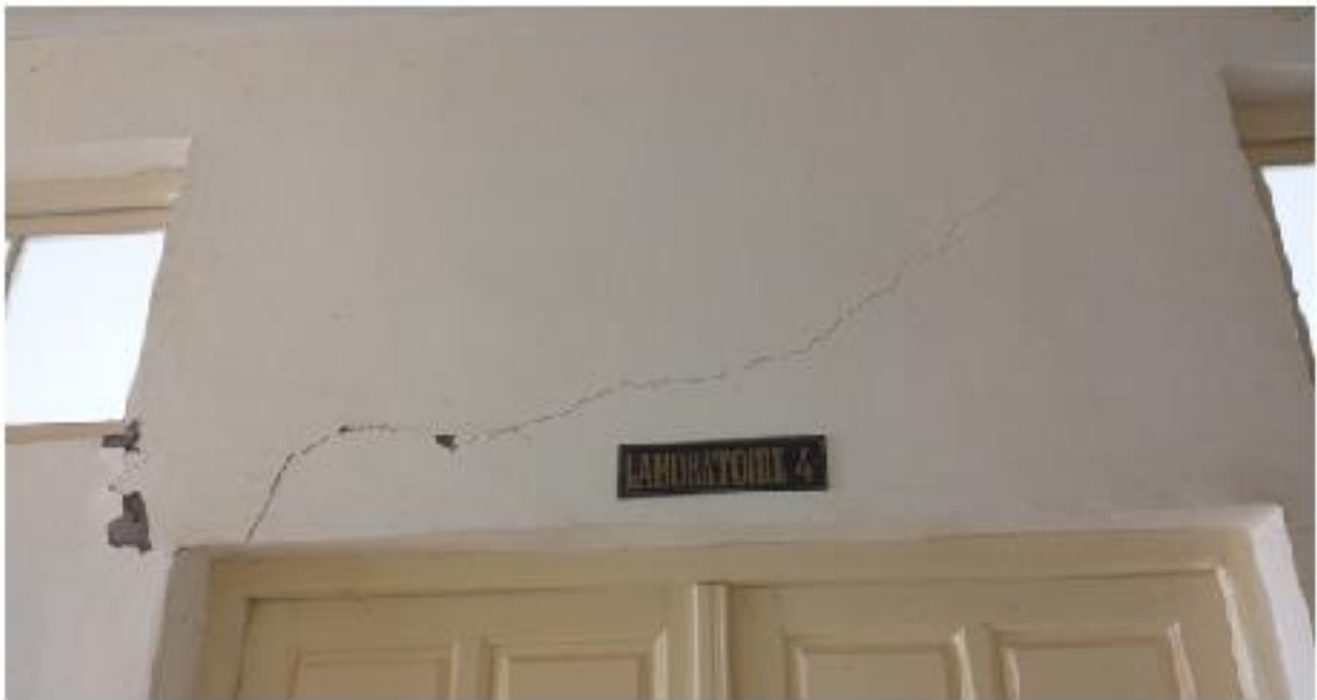
Figure 3.13 : Fissure en moustache au niveau de la maçonnerie du laboratoire 4
