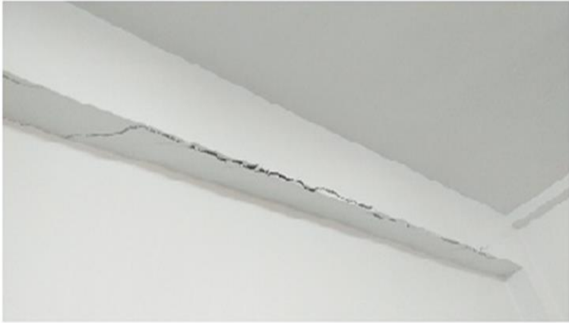
Figure 3.16 : Fissure longitudinale au niveau de la poutre d'enrobage du laboratoire 3
