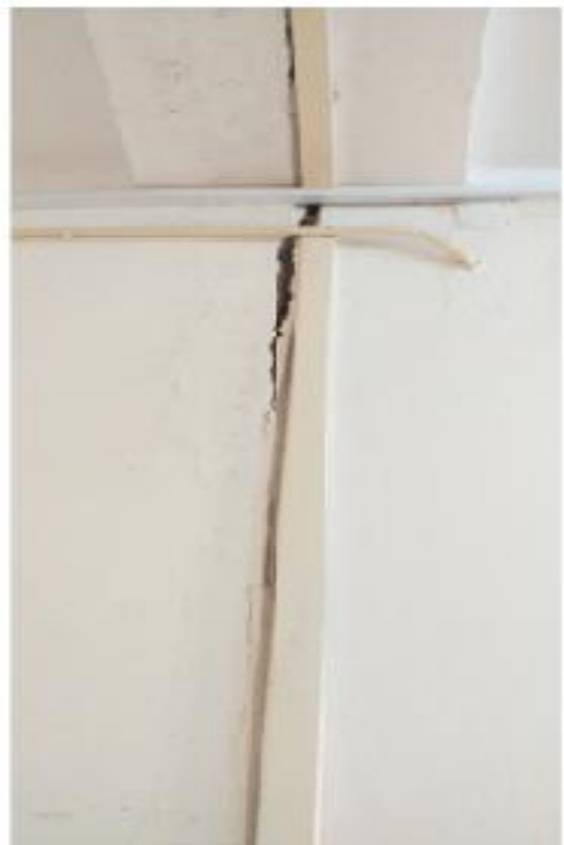
Figure 3.15 : Eclatement du béton au niveau du joint de dilatation
