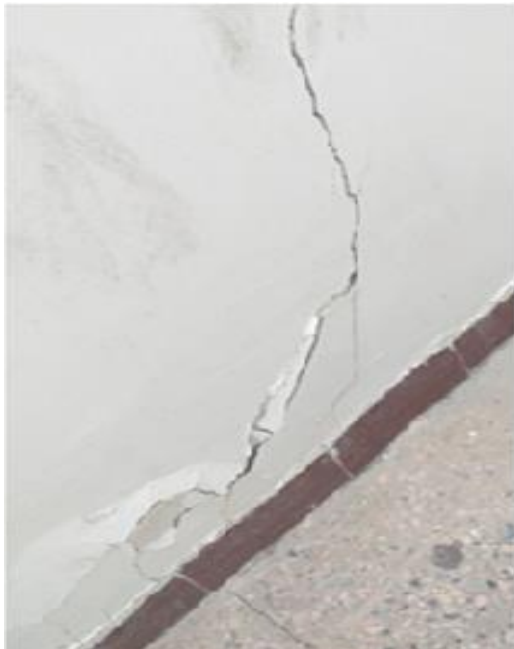
Figure 3.29 : Fissure inclinée au niveau du mur du laboratoire de géotechnique
