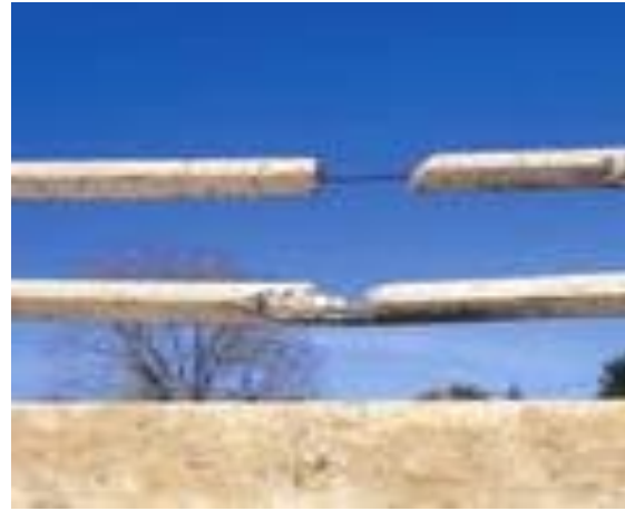
Figure 1.17 : Barrières de retenue dégradée
