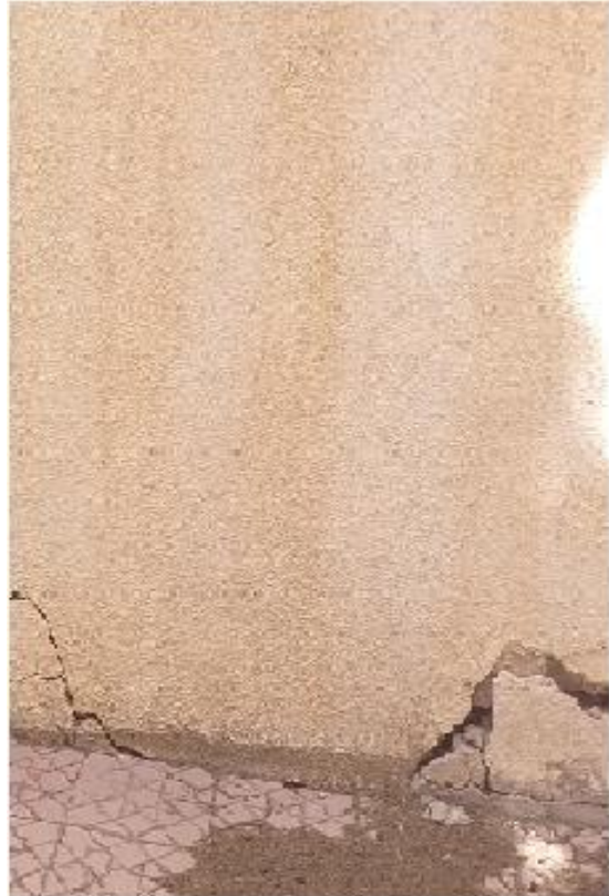
Figure 3.8 : Fissure lézarde au niveau du mur extérieur du bloc des grands amphis
