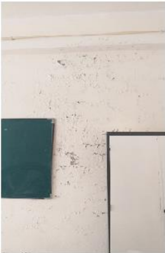
Figure 3.14 : Traces d'humidité sur le mur du laboratoire 3
