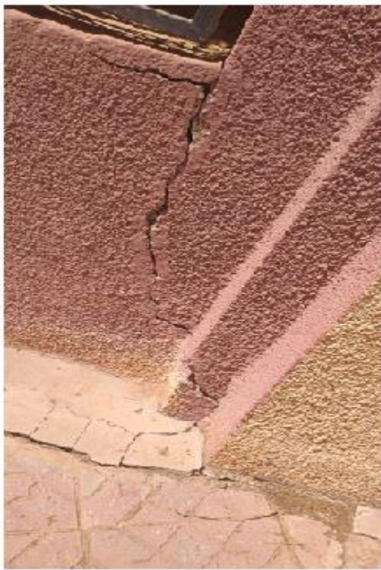
Figure 3.7 : Fissure traversant le mur extérieure du sanitaire
