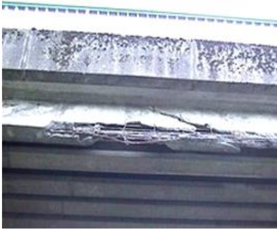
Figure 1.16 : Intrados des ponts dégradés
