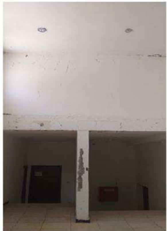
Figure 3.6 : Traces d'humidité sur le mur et le poteau de l'entrée du sanitaire
