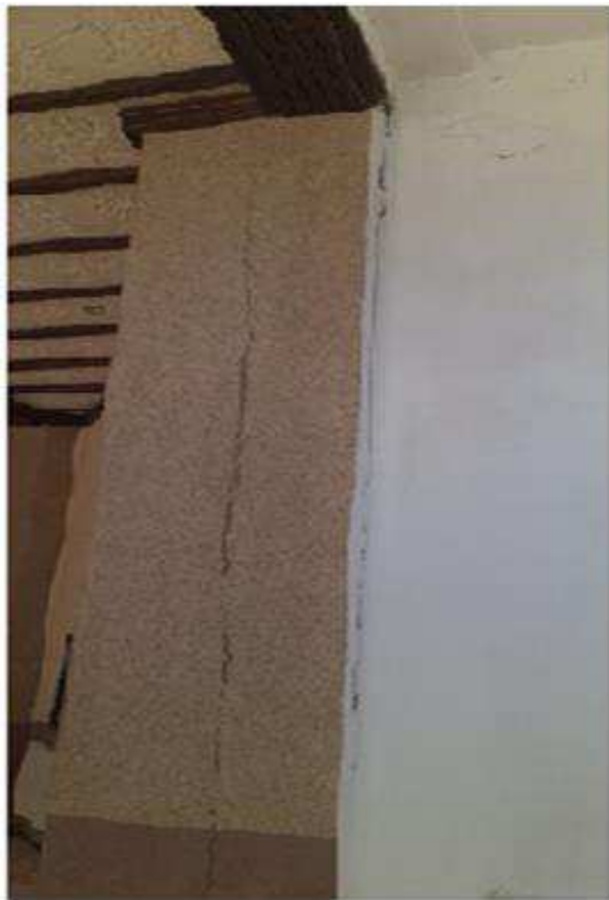
Figure 3.5 : Fissure verticale au niveau du poteau au hall de l'entrée du grand amphi
