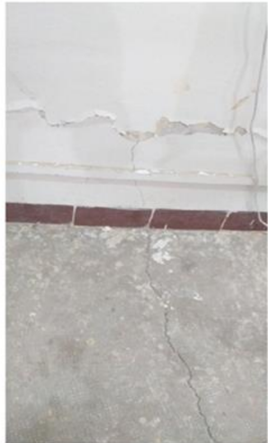
Figure 3.26 : Fissure horizontale au niveau du sol du laboratoire de résistance des matériaux
