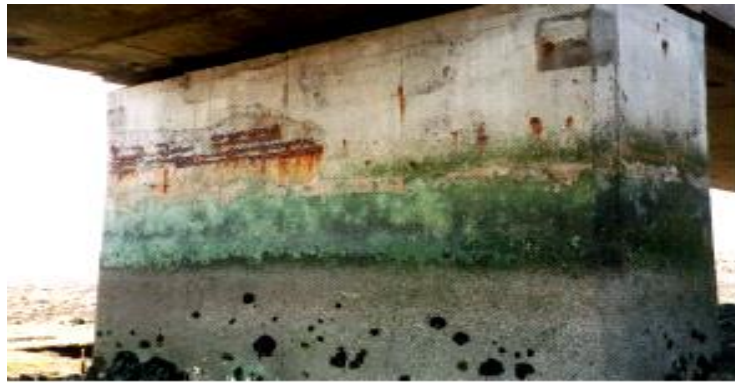
Figure 1.21 : Pile en zone de marnage
