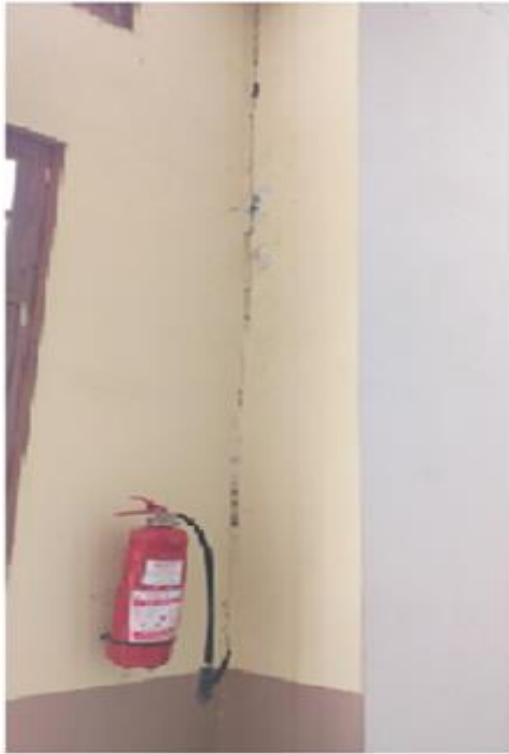
Figure 3.3 : Fissure verticale au niveau du poteau au hall de l'entrée du bloc du grand amphi
