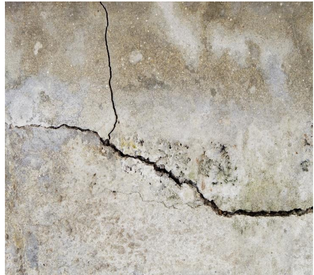
Figure 1.8 : Fissure au niveau d'un mur
