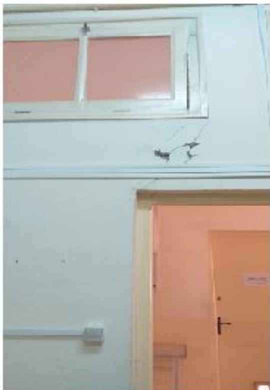
Figure 3.20 : Fissure au niveau du mur du laboratoire 4
