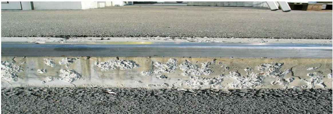
Figure 1.15 : Exemple de dommages causé par le gel-dégel
