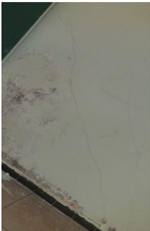
Figure 3.1 : Fissure de 45° au niveau du grand amphi G3
