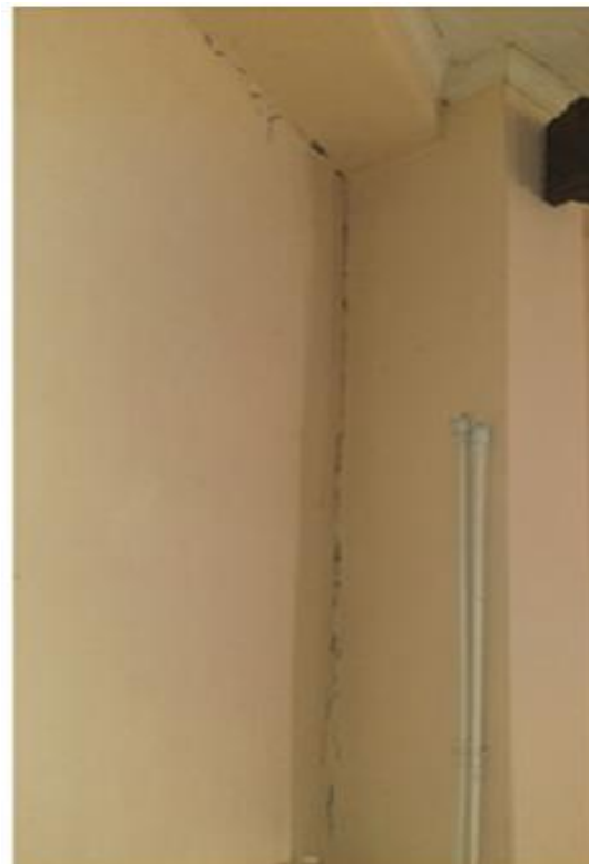
Figure 3.2 : Fissure verticale au niveau du poteau du grand amphi G2
