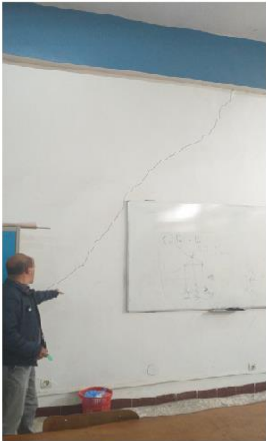
Figure 3.25 : Fissure inclinée au niveau du mur du laboratoire de mécanique
