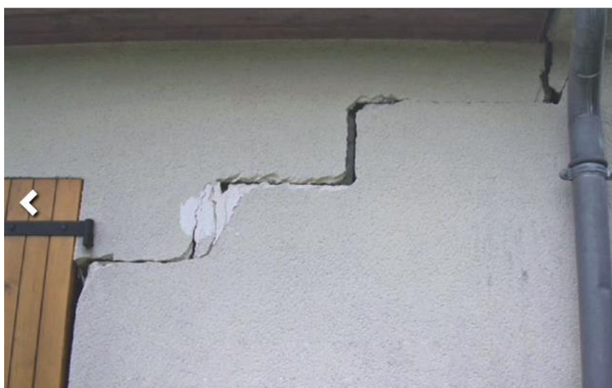
Figure 1.10 : Fissure en escalier
