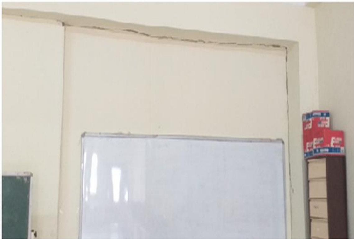
Figure 3.17 : Fissure très importante au niveau du joint de dilatation de la salle 16
