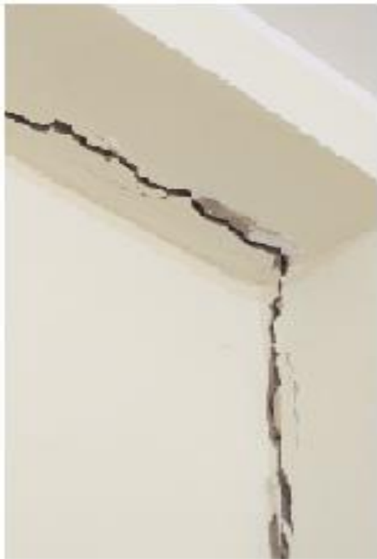
Figure 3.18 : Fissure lézarde au niveau du joint de dilatation de la salle 16
