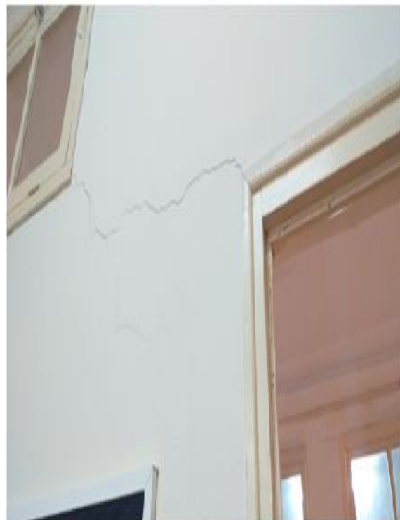
Figure 3.12 : Fissure en moustache au niveau de la maçonnerie du laboratoire de chimie
