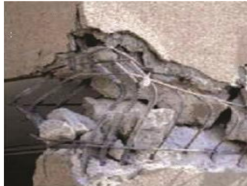
(e) Ecrasement du béton et flambement des armatures
