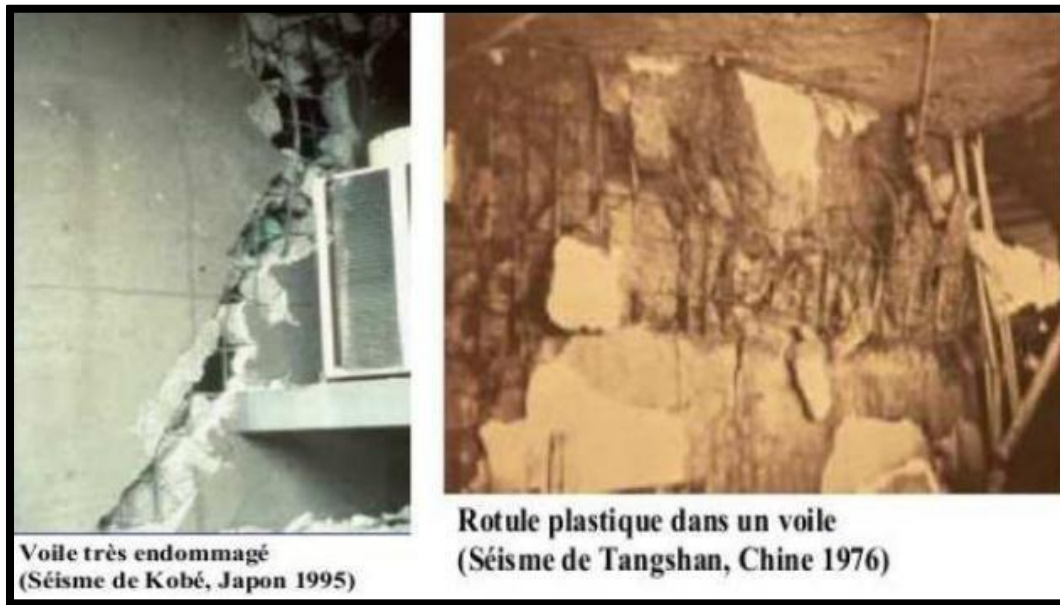
Figure 1.3 Dégradation des structures en voile au niveau de la zone critique face aux séismes (8) .
