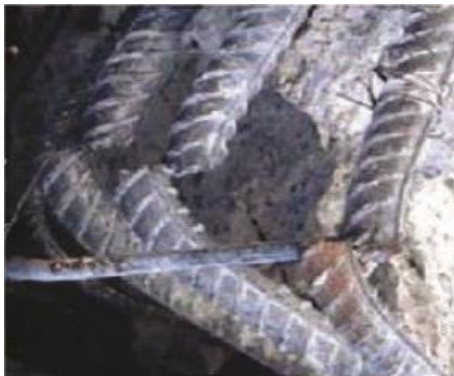
(d) Rupture des armatures
