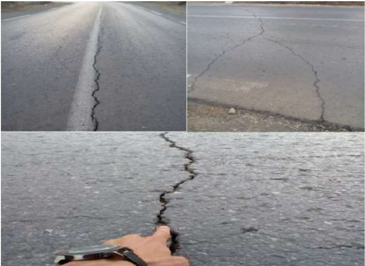
Fig. 30: Fissuration de la route liée aux vibrations.
