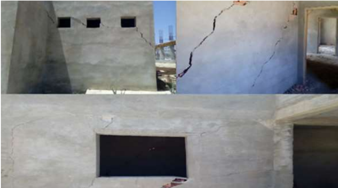
Fig. 31: Fissuration d'une habitation liée aux vibrations.
