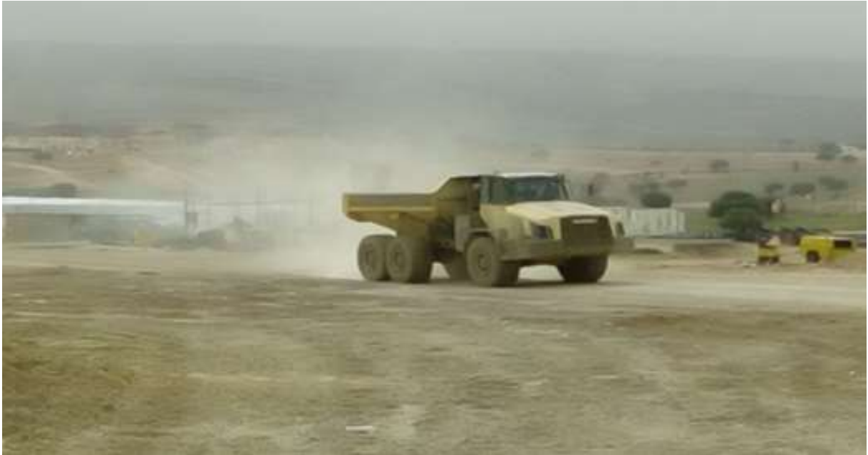
Fig. 40: Emission des poussières par un camion de transport.
